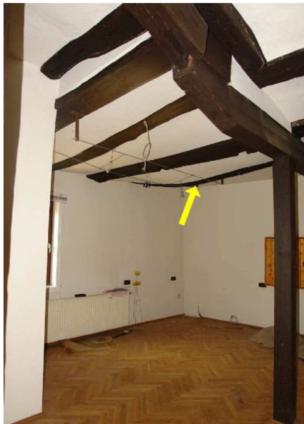
Abb. 10/1: Raum 1.1, Untersicht der Decke mit Blick auf den nordöstlichen De- ckenbalken mit starker Durchhängung (gelber Pfeil), Zustand vor der Freilegung, Blick gegen Norden; Foto IBD, Sept. 2015
