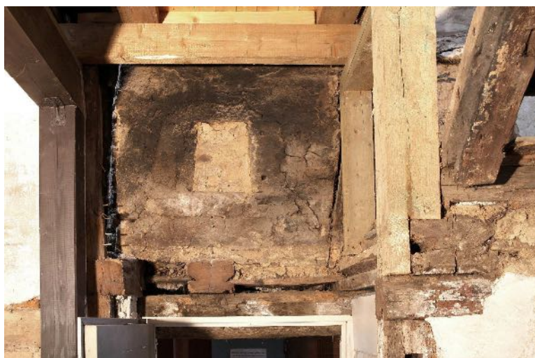
Abb. 21/3: Vorderhaus, EG, Raum 1.1, gemauertes Ofenloch mit Werkstein- rahmen in der NO- Wand unterhalb der ursprünglichen Ge- schossdecke zwischen EG und OG, Blick nach NO; Foto IBD, Juni 2019
