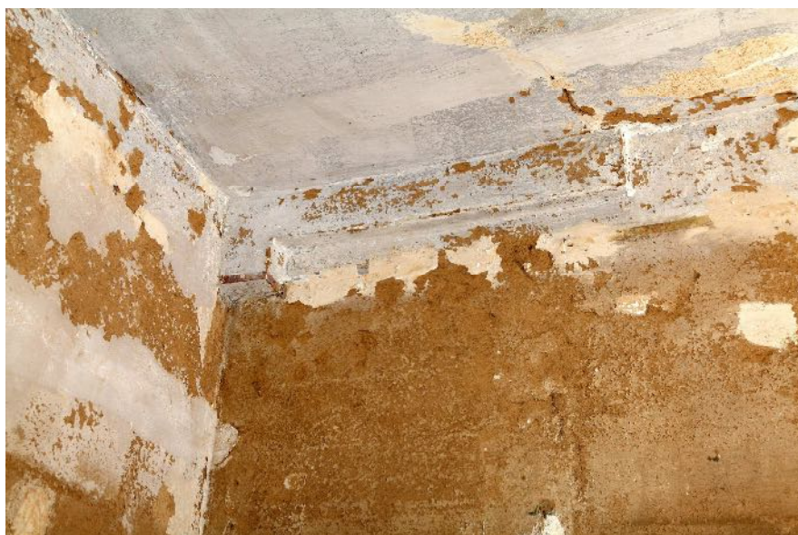
Abb. 4/2: Südwestliches Ende des abgeschnittenen Deckenunterzugs und des darunter liegenden Sattelholzes unter jüngerm Verputz, Blick gegen SO; Foto IBD, Juni 2019
